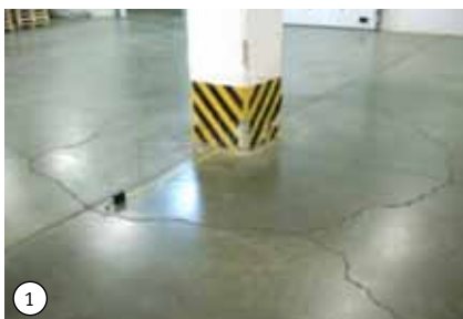
1 Сквозные структурные трещины в бетонном полу
