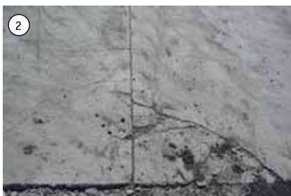
2 Трещины и сколы при короблении углов плиты пола
