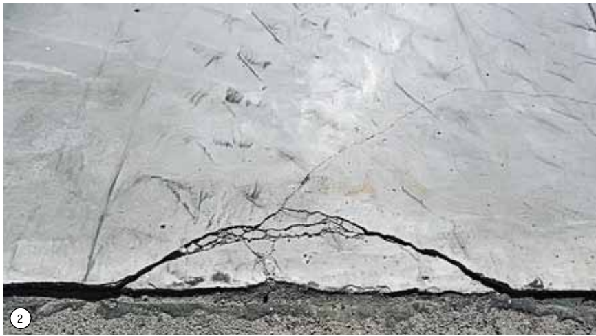
Скол края бетонной плиты и уступ между смежными плитами пола
