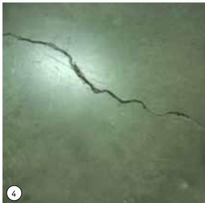
4 Сколы кромок трещины в бетонном полу
