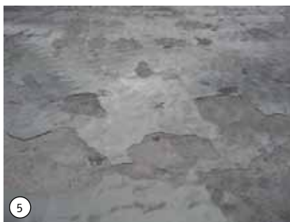
5 Шелушение поверхности бетонного пола
