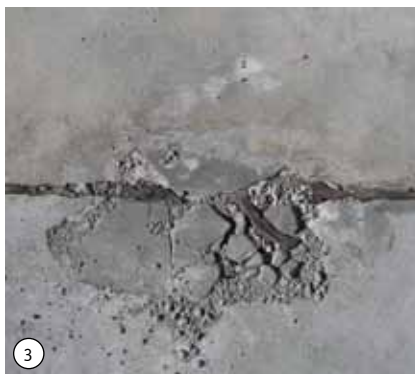
3 Выбоина в бетонном полу
